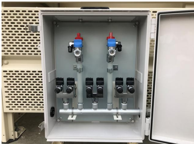
・災害時ガス器具ガス取り出し口
