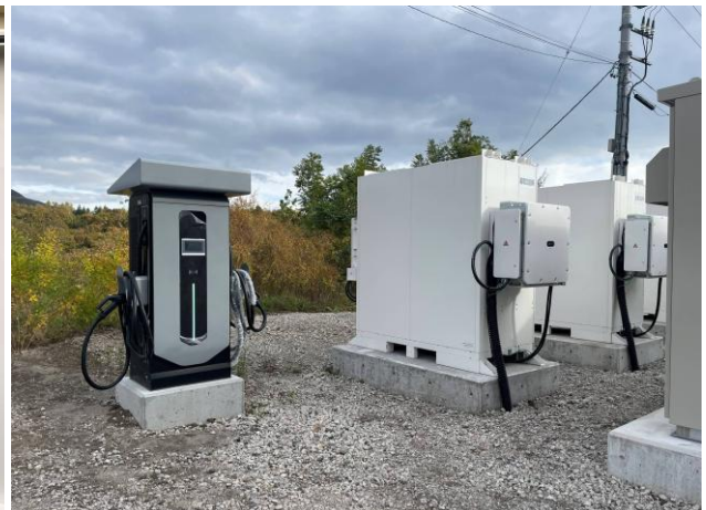
・EV車充電設備、蓄電池設備
